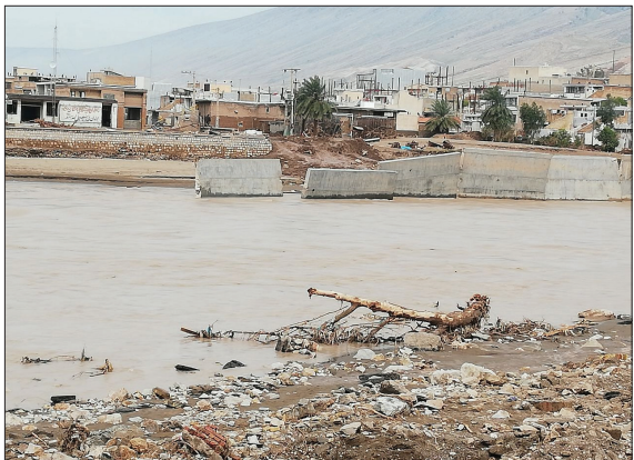
شکل ۵- شکست دیوارهای حفاظتی کنار رودخانه و ورود پر قدرت جریان به مناطق شهری
