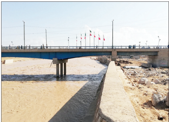
شکل ۴- انسداد غیر مهندسی دهانه پل در اثر احداث سازه حفاظتی در کنار رودخانه
