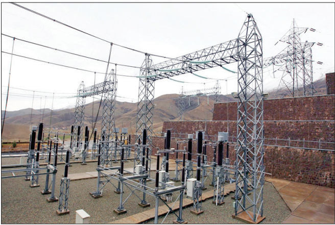
پست انتقال نیروی برق
